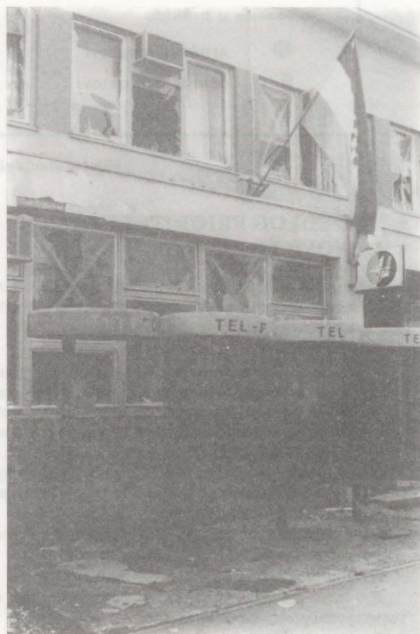
Slika 8. Razorena zgrada osječke Pošte
